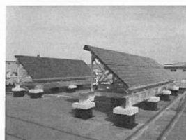
太陽光発電システム（15kW）
