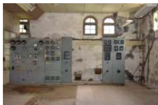
写真 3-17 第二水車発電機の監視盤
