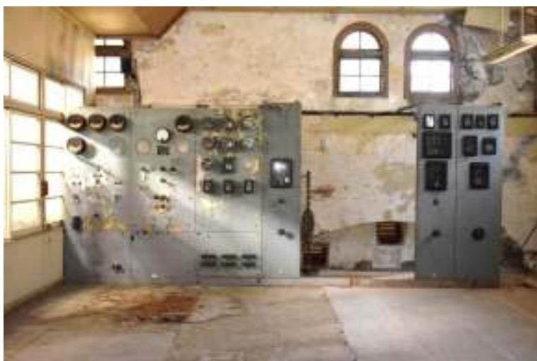
1-3 第二水車発電機用監視盤
