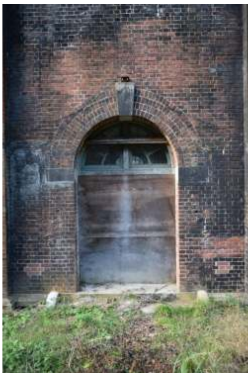
写真 3-37 南東開口部 屋根取付き跡
