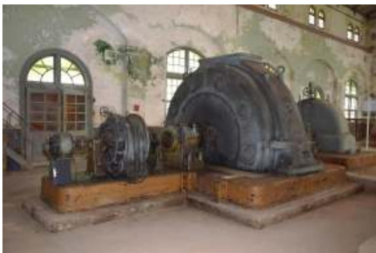
1-1 第二水車発電機
