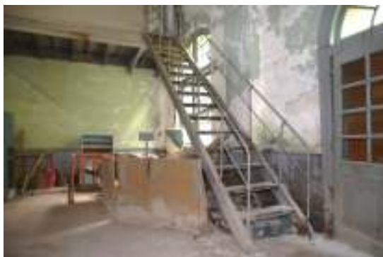
写真 3-16 配電盤室 2階へ上がる階段
