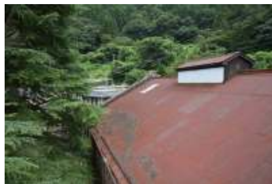
写真 4-11 スギが屋根に接している
