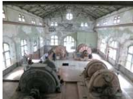
写真 3-7 2 階配電盤室からタービン室を望む
