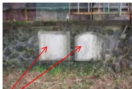
第二水車発電機部分の風洞
