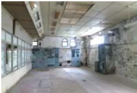
写真 3-14 配電盤室 2階南から北を見る
