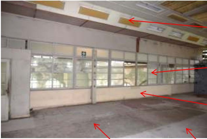
配電盤室 西面
