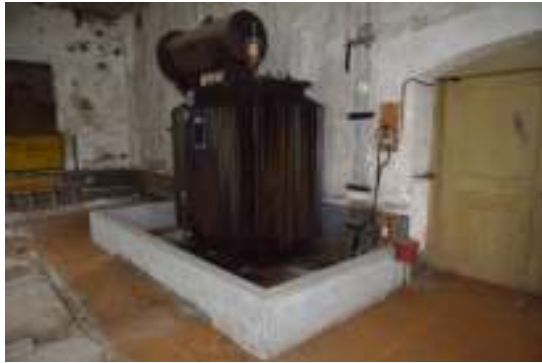
写真 3-12 回轉變流機用変圧器
