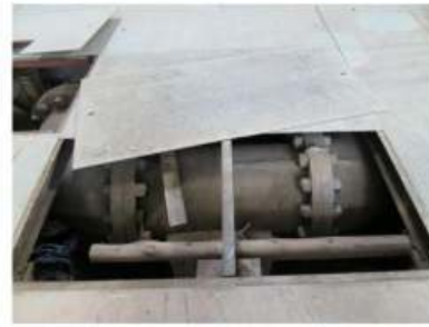
水圧鉄管 鉄板を一部ガラスに替えて鉄管を見せる。
