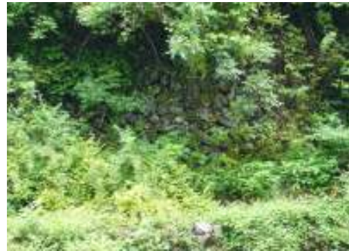
写真 6-18 県道下石積みの状況 (遊歩道の擁壁工事必要)
