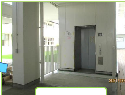
エレベーター
