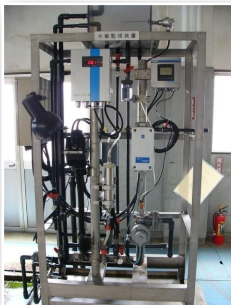
【水質監視装置（滝の宮送水場）】
