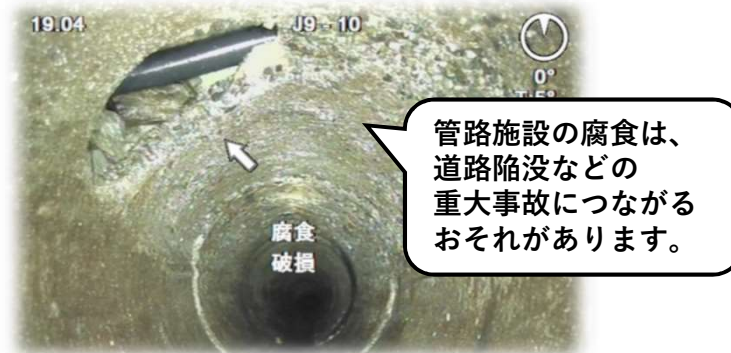
<下水道管路施設の腐食破損状況>
