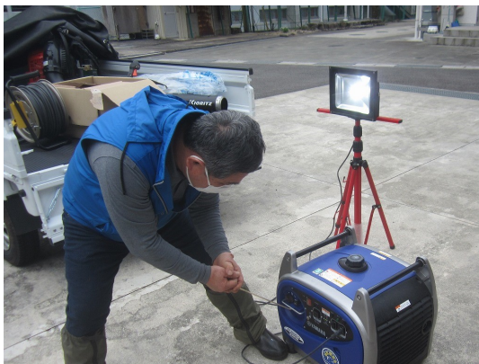
【発電機等点検】
