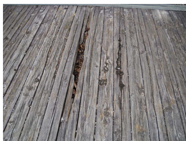
木橋の腐朽の進行（池田池公園）
