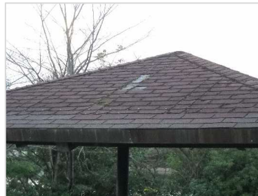
四阿屋根の劣化（池田池公園）
