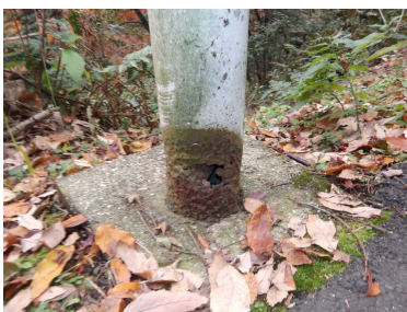
ガードパイプ地際部の孔食（滝の宮公園）
