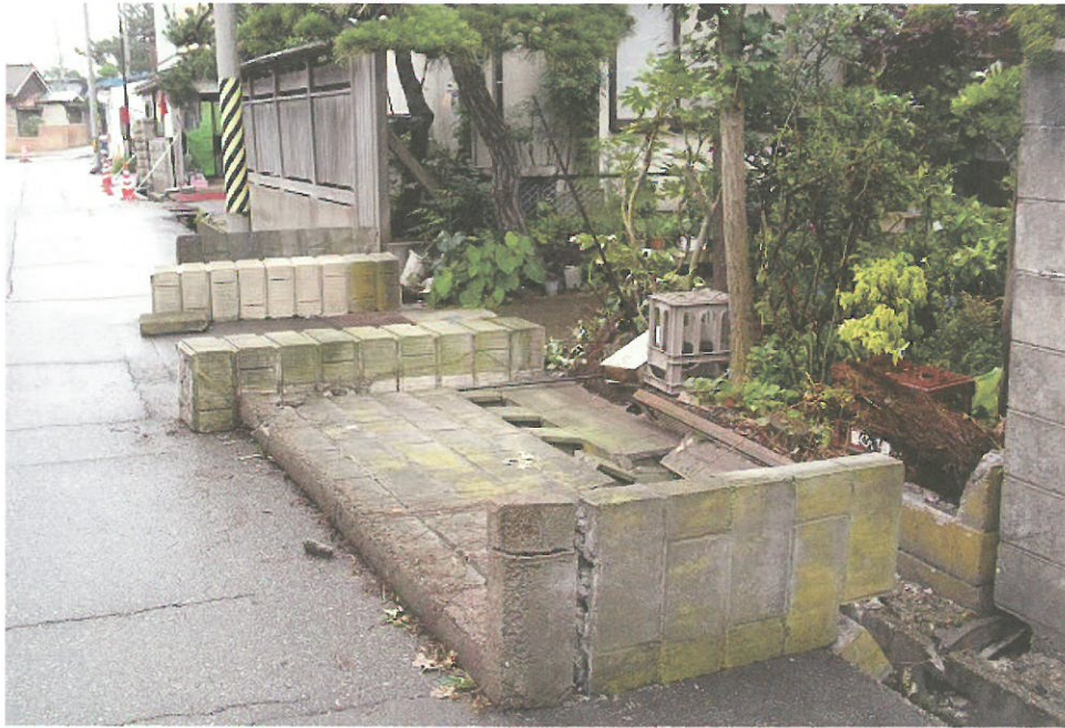
地震により、倒壊したブロック塀(平成 19 年新潟県中越沖地震) (写真提供：埼玉県)
