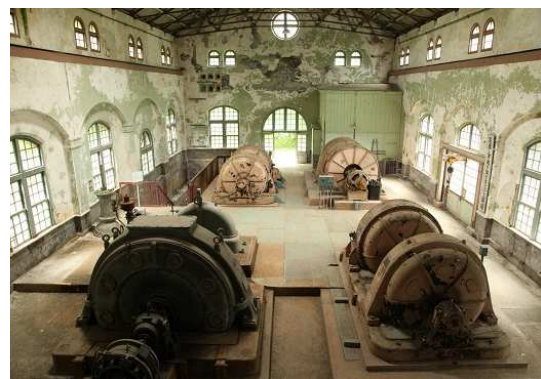
旧端出場水力発電所内 発電設備
