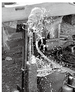
凍結による破損漏水
